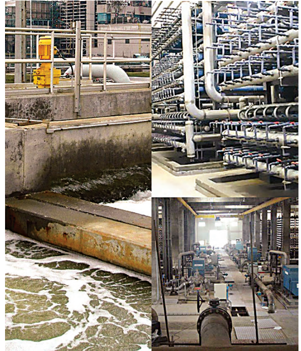
పటము 2.12 మింజూర్ లవణములను తొలగించు స్థావరము (తిరువళ్ళూర్ జిల్లా)
